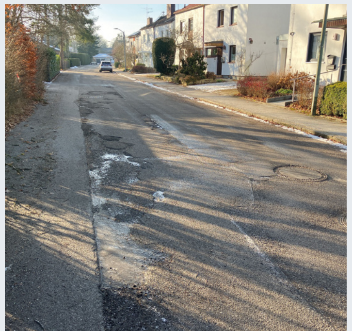
Die Ulmenstraße in Vaterstetten erfordert eine Komplettsanierung, für die mindestens drei Monate Arbeit angesetzt sind.
